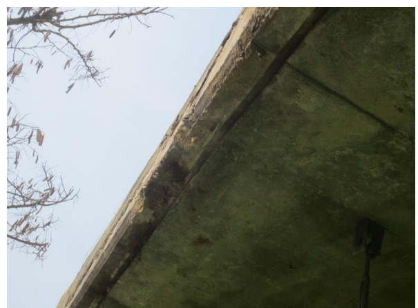
바닥판 파손 S3
