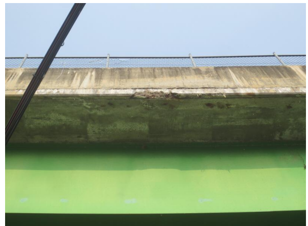
바닥판 파손 S3
