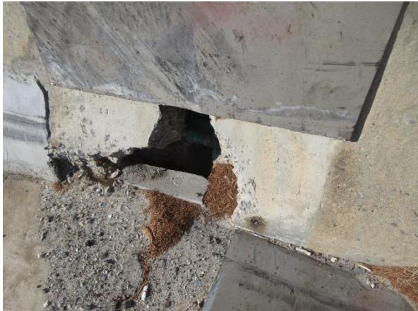
방호벽 파손 S3
