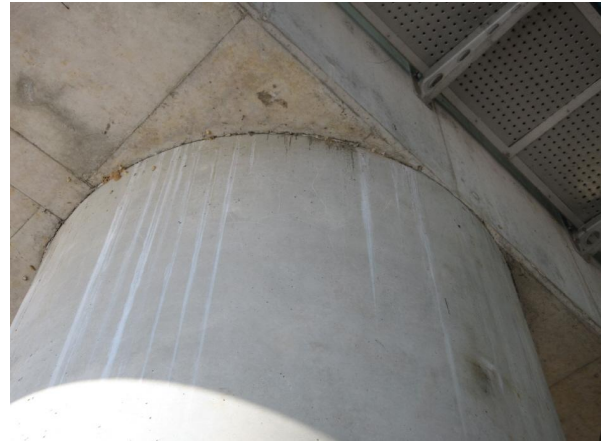
교각 망상균열 P2
