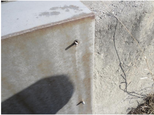
차수판 볼트탈락 Exp.Joint-A2
