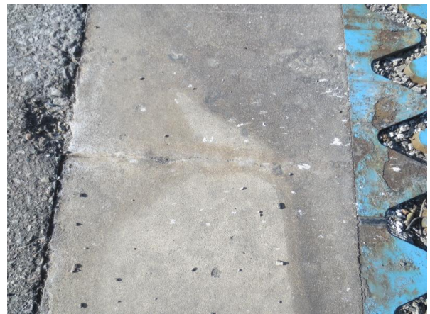
후타재 균열 (0.3mm미만) Exp.Joint-A1
