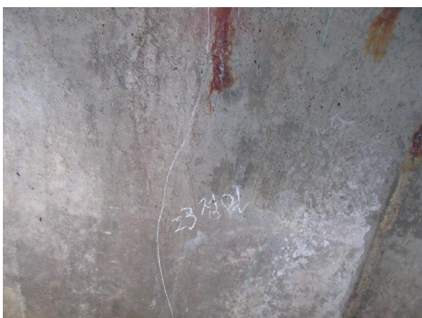
교대 균열(0.3mm미만) A1
