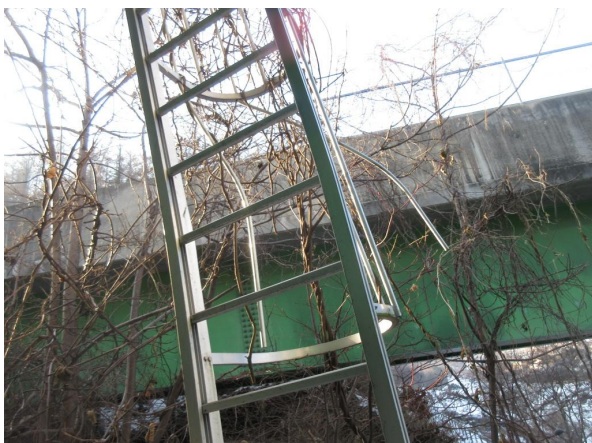
점검사다리 난간 파손 A1
